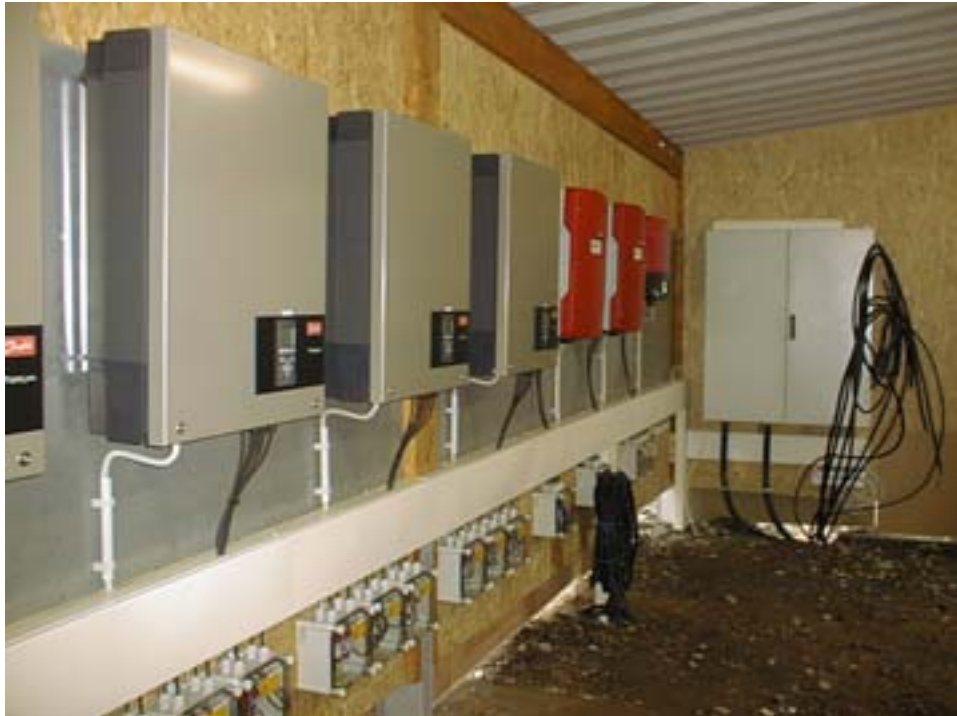
Abb. 22: Weitere Innenaufnahme des Technikraumes, Wechselrichter und Kombiableiter
