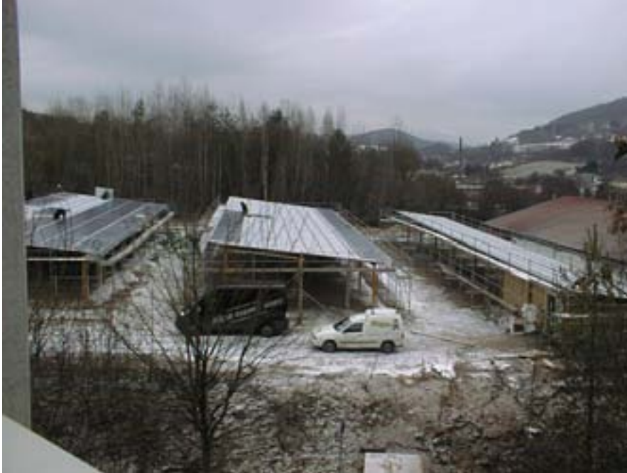
Abb.19: Ein Teil des Carports ist bereits mit PV-Modulen belegt.
