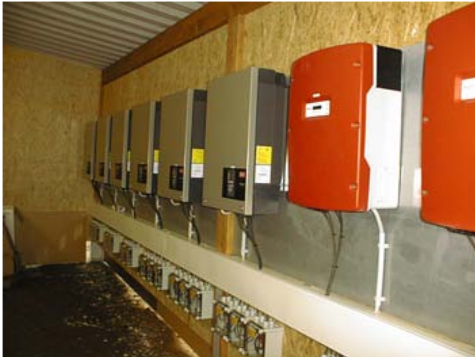
Abb. 21: Innenaufnahme des Technikraumes, Wechselrichter und Kombiableiter
