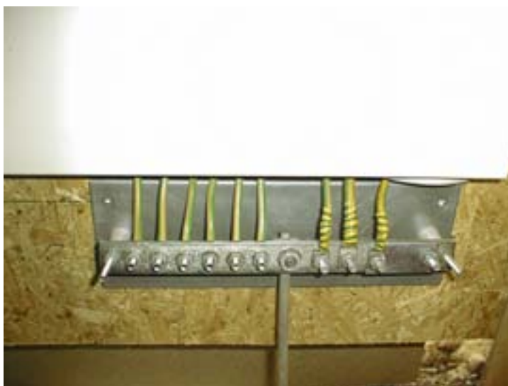
Abb. 12: Die Hauptpotenzialausgleichs-Schiene im Technik-Gebäude. In der Mitte ist der Ringerder angeschlossen.
