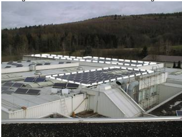
Abb. 11: Fertiggestellte PV-Anlage, Nennleistung 40 kWp.
