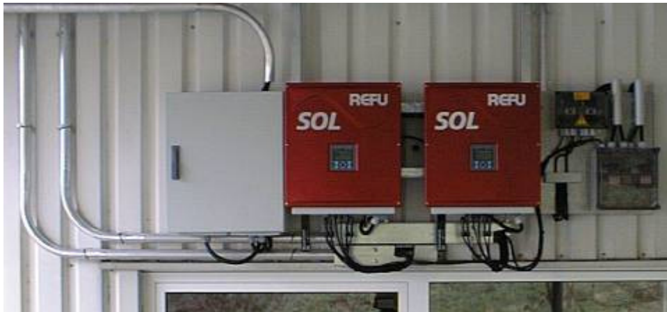
Abb. 10: Unterverteilung, zwei Wechselrichter, Überspannungsschutz
