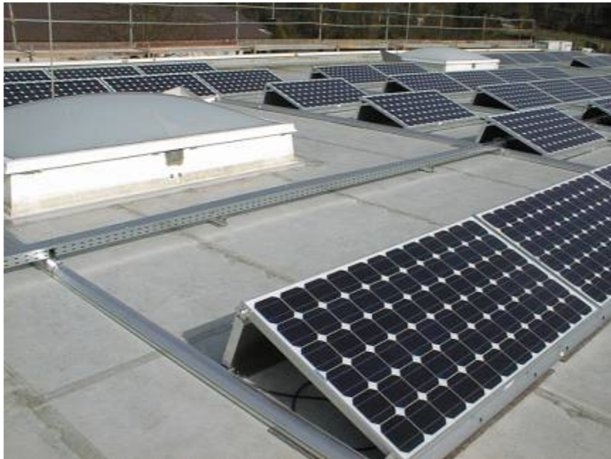
Abb. 4: Leitungsführung in Modulrahmen und metallendem Kabelkanal.
