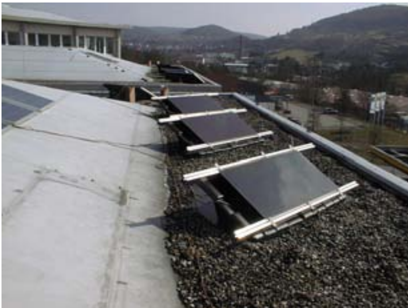
Abb.2: Solartechnics Module, nach Westen ausgerichtet
