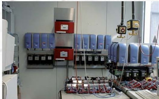
Abb. 4: Mess- und Einspeise-Station
