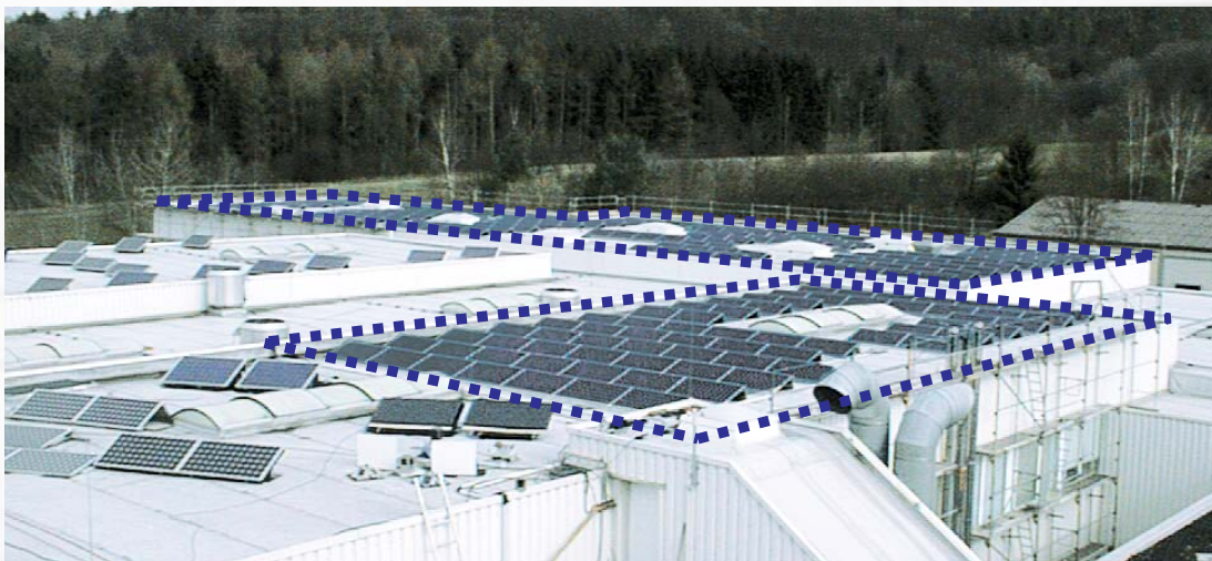
Abb. 11: Fertiggestellte PV-Anlage, Nennleistung 40 kWp.
