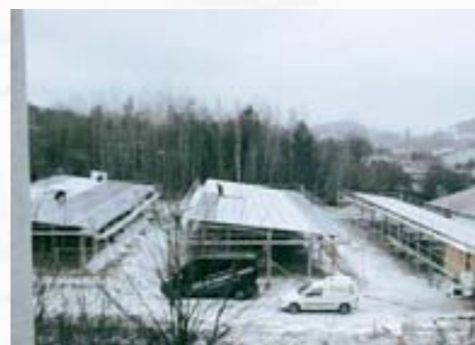
Abb. 5: Ein Teil des Carports ist bereits mit PV-Modulen belegt
