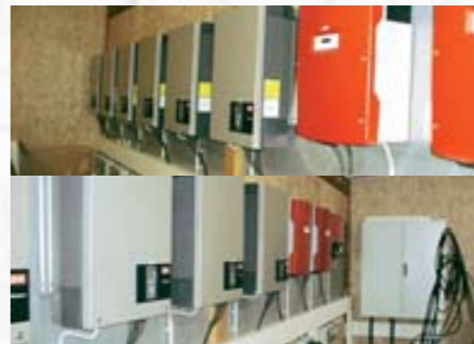
Abb. 7/8: Innenaufnahme des Technikraumes, Wechselrichter und Kombialeiter kurz vor der Inbetriebnahme
