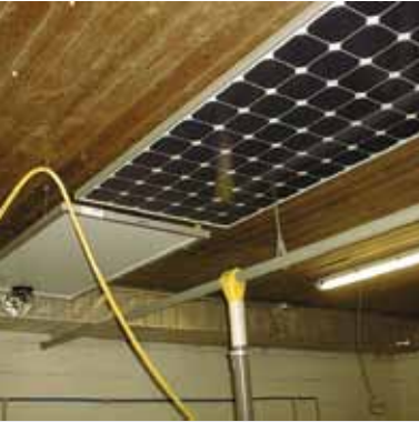
Abb. 9: Module unter der Schweinestall-Decke
