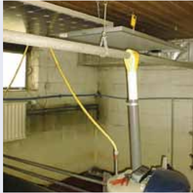
Abb. 10: Module unter der Schweinestall-Decke
