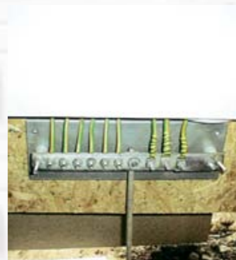
Abb. 21: Die Hauptpotenzialausgleichs-Schiene im Technik-Gebäude. In der Mitte ist der Ring-Erder angeschlossen
