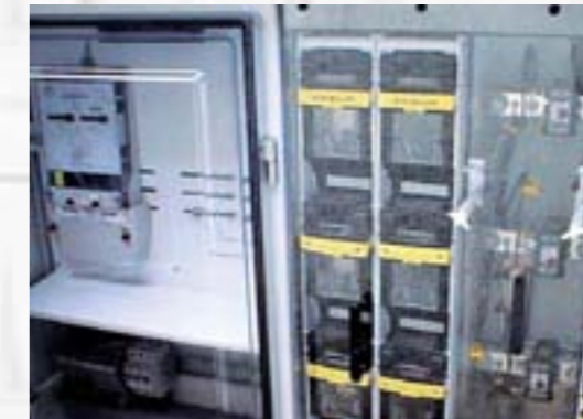
Abb. 9: Innenansicht des Messwandler-Schranks
