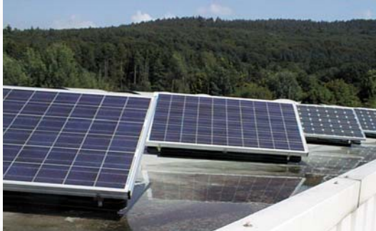
Abb. 1: Ein Teil der Testanlage
