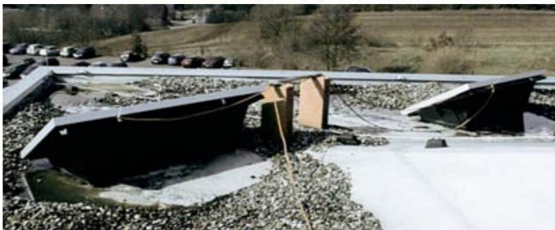
Abb. 5: Die beiden nach Westen ausgerichteten SCHOTT Module von hinten gesehen
