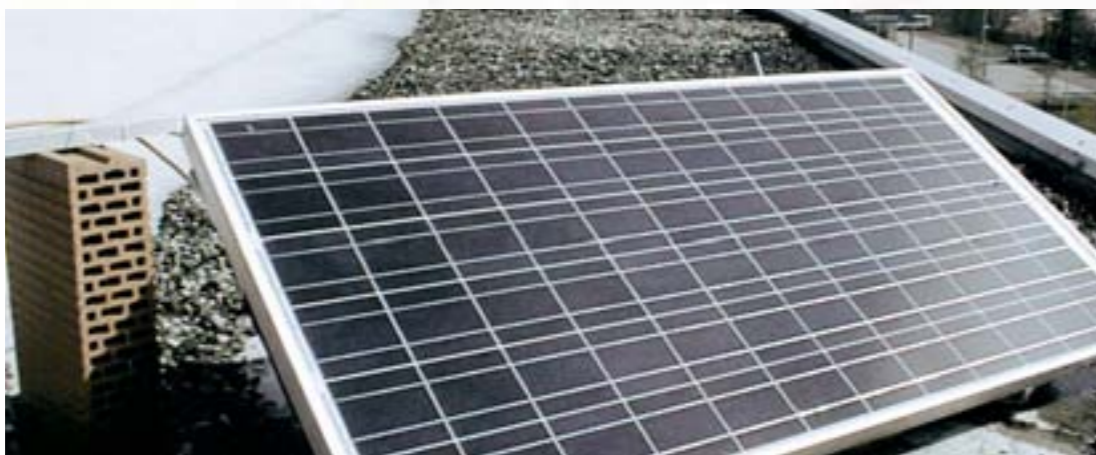
Abb. 4: Eines der beiden nach Westen ausgerichteten SCHOTT Module.
